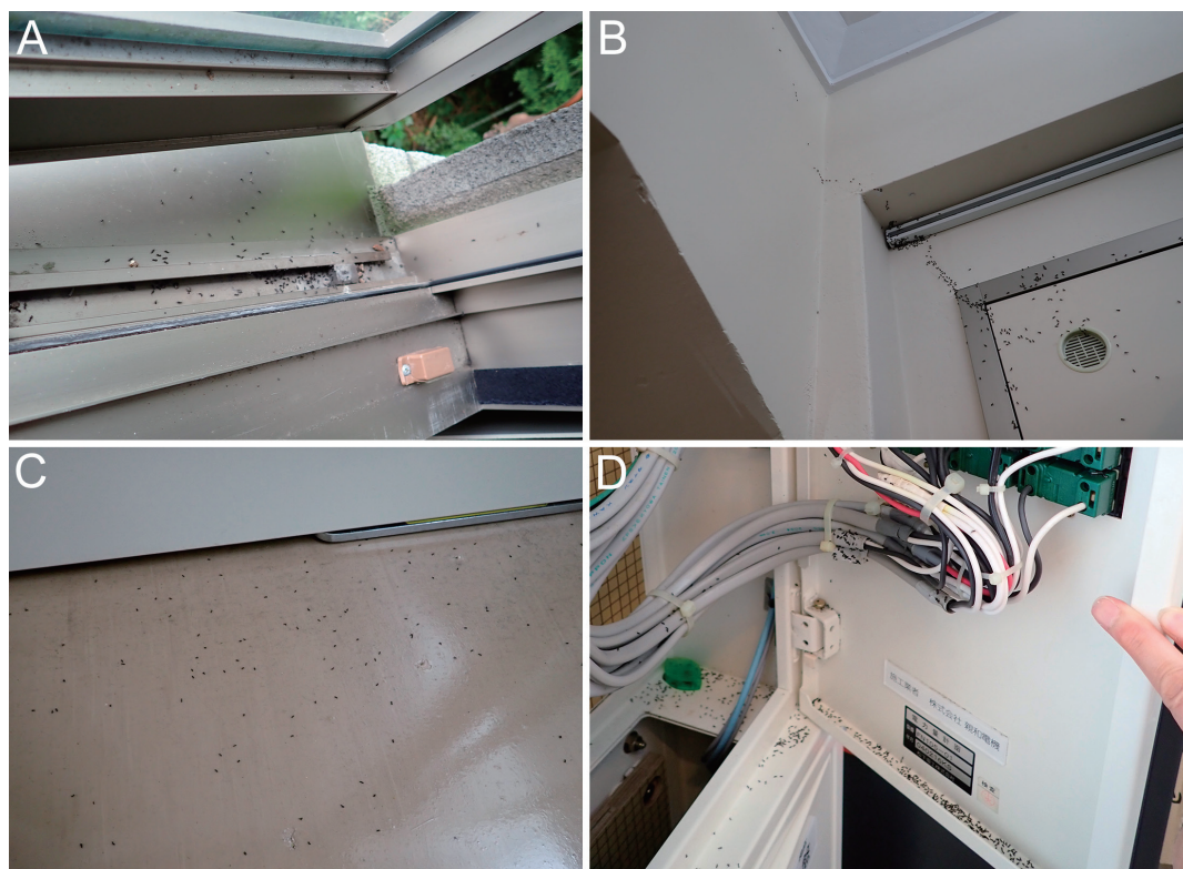
図1. アシジロヒラフシアリの建物や屋外設備への侵入状況。
